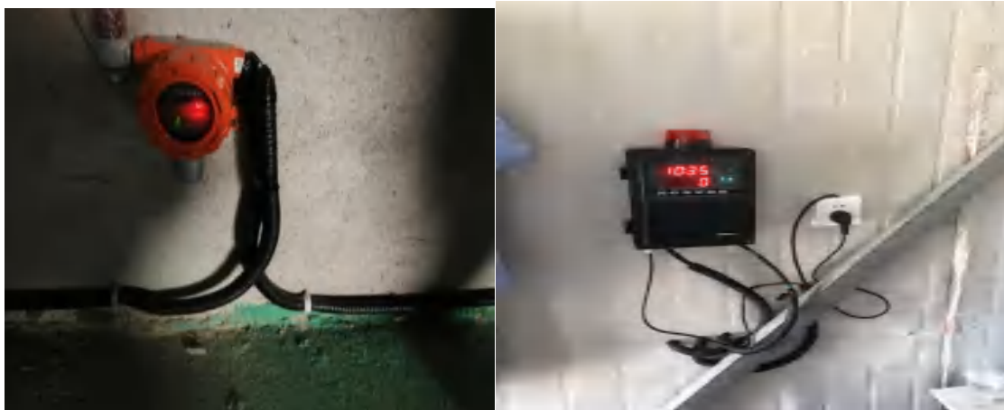
图 2.6-2 可燃气体探测器照片
