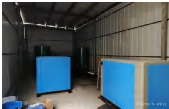
图 2.6-3 空压机及储罐
